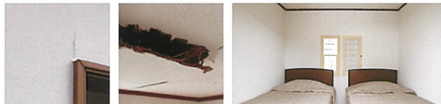
開口部周辺クロスめくれの亀裂 天井の損傷 シェルターの様子
