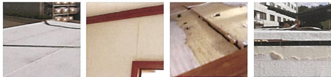
屋根面クロスめくれのしわ 内壁クロスめくれのしわ 床下地合板の浮き上がり 屋根パネル合板の浮き上がり
