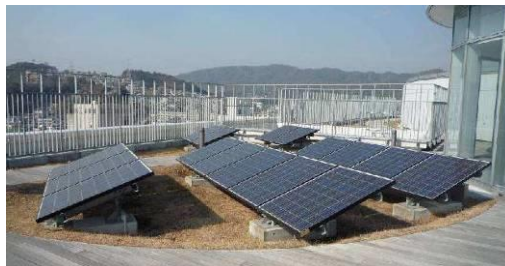
太陽光パネル
