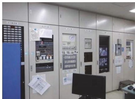
防災放送関係機器不良
