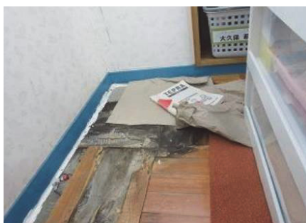
漏水跡（クロスめくれ、床捲れ）
