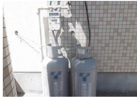
プロパンガス配管塗装劣化
