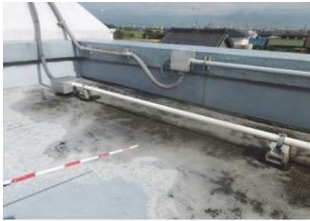
防水層表面劣化、水溜り
