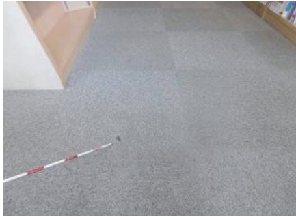
カーペット汚れ、クロス剥がれ
