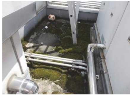
土砂堆積、ドレン詰り
