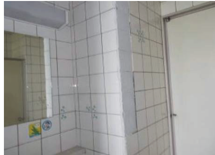
便所タイル破損
