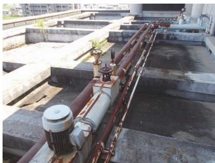
電線管・配管錆
