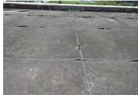
目地めくれ（全面）、雑草繁茂
