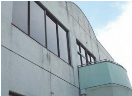
汚れ、表面劣化
