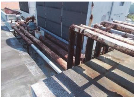
配管、空気調和機器チラー等錆
