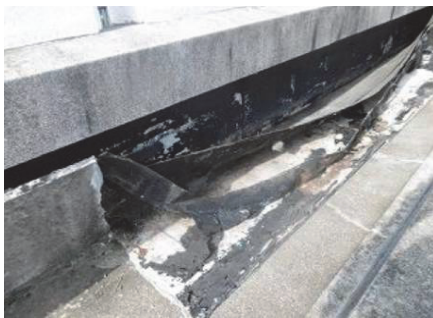
防水シート剥がれ多数、苔等繁茂
