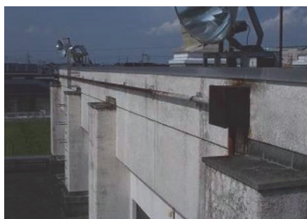
プルボックス、電管錆
