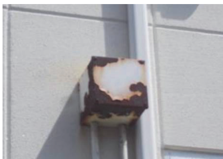
電気プルボックス錆
