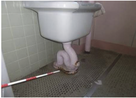
排水管流し錆
