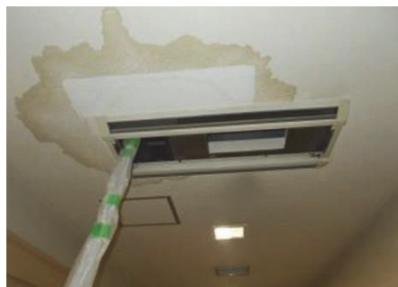
ファンコイル故障、天井漏水跡
