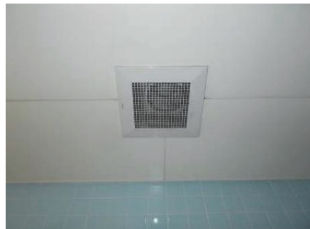
換気扇故障（複数あり）
