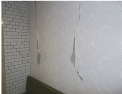
クロス剥がれ、タイル浮き
