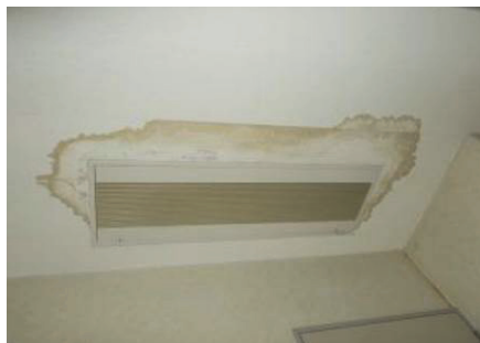
天井空調漏水跡、スイッチ故障
