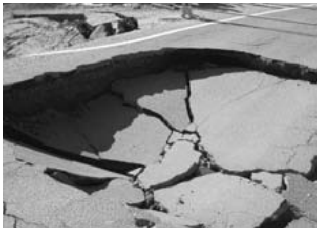
篠田橋の陥没
