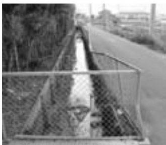
悪臭のひどい水路
