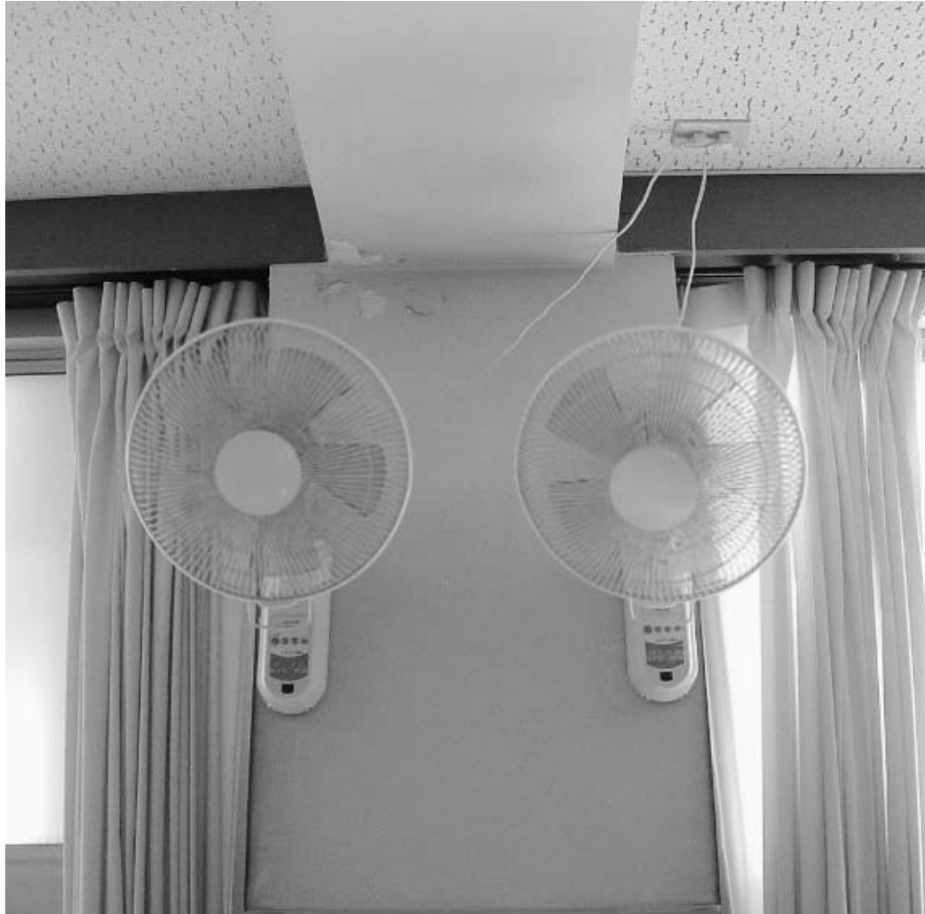
美和地区の小中学校に設置されている壁かけ扇風機
