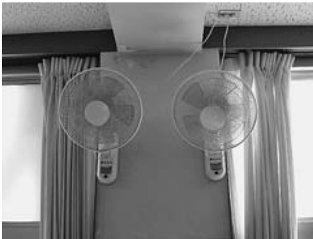
教室に設置されている扇風機
