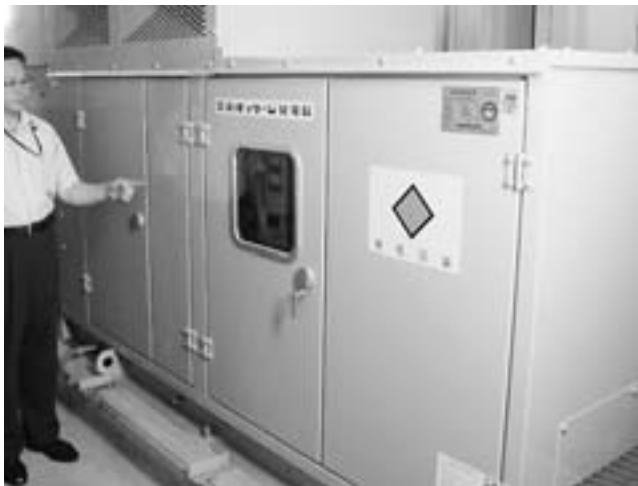
甚目寺庁舎地下に設置の自家発電装置
