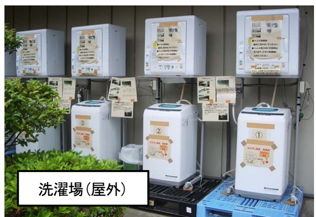
↑ 屋外の軒下に設置された洗濯機と乾燥機 「ペットの衣類を入れないで」など、使用時の注意が書かれている。
