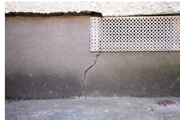
基礎のひび割れ
