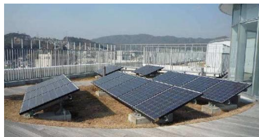
太陽光パネル
