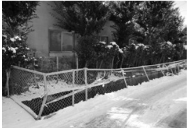
ふたがされていない公共用水路
