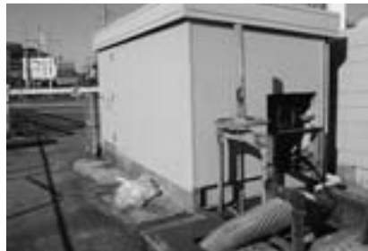
下萱津地区の池端排水機場
