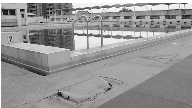
修繕が待たれる市民プール
