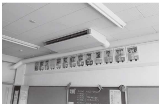
エアコン設置された教室
