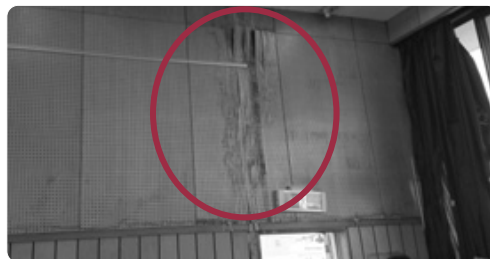
武道場の雨漏り跡
