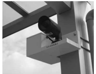
防犯協会が設置した防犯カメラ
