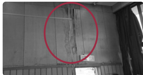
武道場の雨漏り跡
