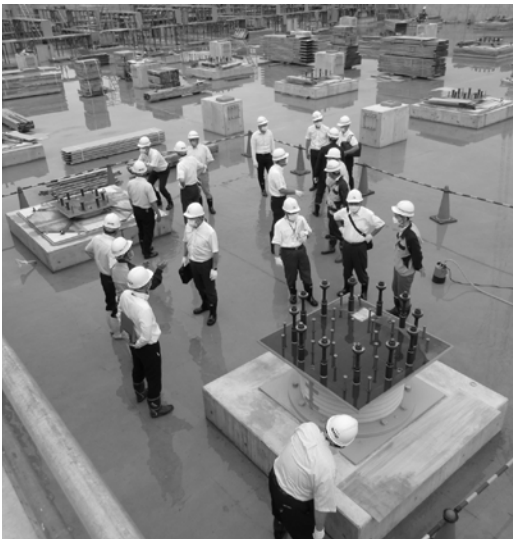
地震対策の要となる免震ダンパー
