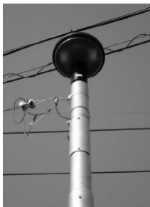
今回導入されたLED道路照明灯
