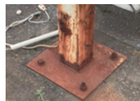
鉄骨のさび・ 塗装の老朽化
